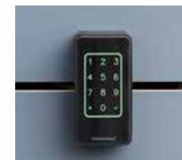
Das Aus für den Schlüssel: Zwei Keypads regeln den Zutritt zur Lounge digital. Ein großer Vorteil, denn es muss nun niemand mehr zum Aufschließen vorbeikommen.
