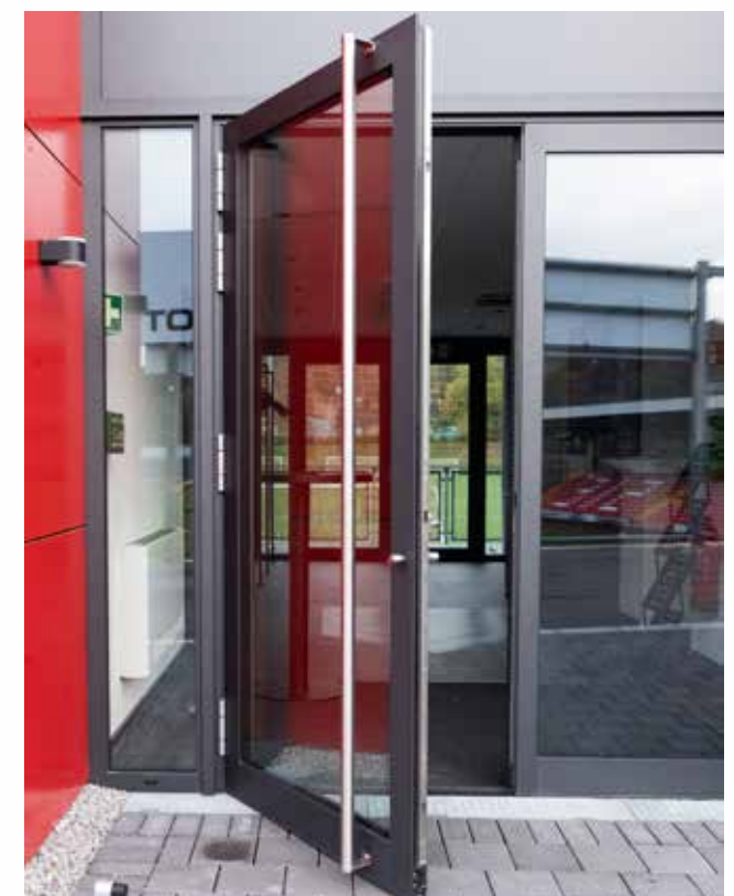
Verbindung aus Sicherheit und edler Optik: In den vier Eingangstüren zur VIP-Lounge sorgen die GENIUS Motorschlösser mit Panikfunktion für das vollmotorische Ver- und Entriegeln – schnell, leise und ohne klassischen Schlüssel. Die Türen sind ebenfalls mit einer hochwertigen, kaum hörbaren Softlock-Falle im Hauptschloss ausgestattet, die im geöffneten Zustand nicht zu sehen ist.
